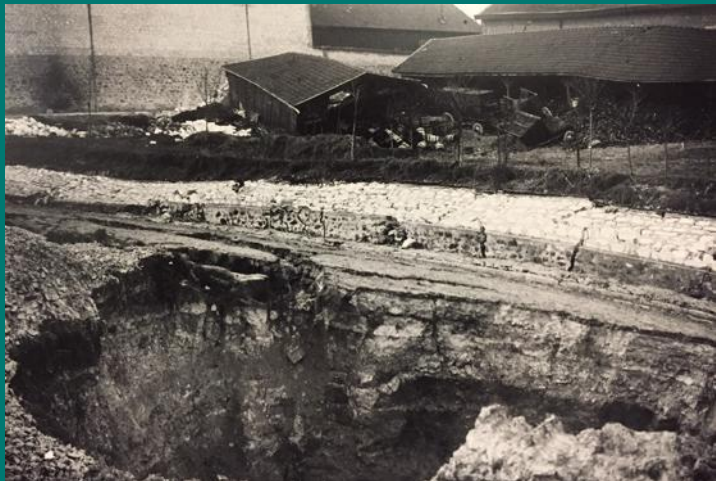
A80 Epernay - Le fontis visible au premier plan permet de distinguer une stratigraphie de remblai qui ne correspond pas à la craie en place - SIRGE
