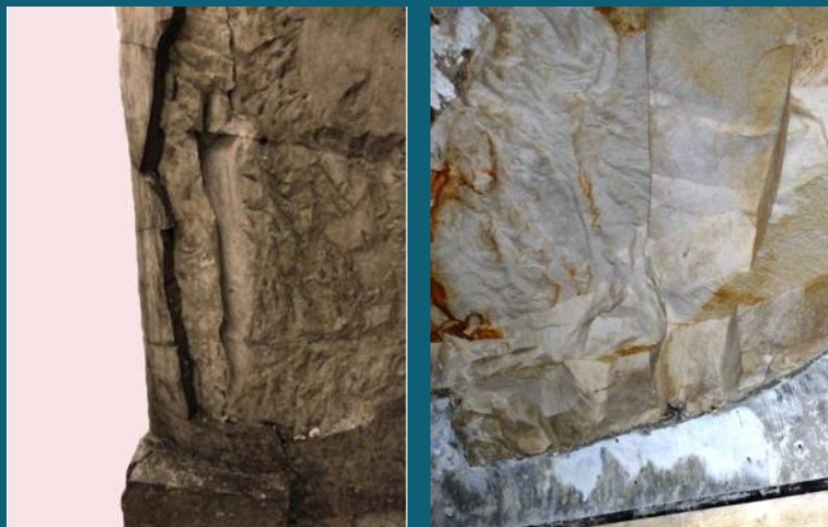
C172 C173 Méfaits des enduits ciments sur la craie - PHT
