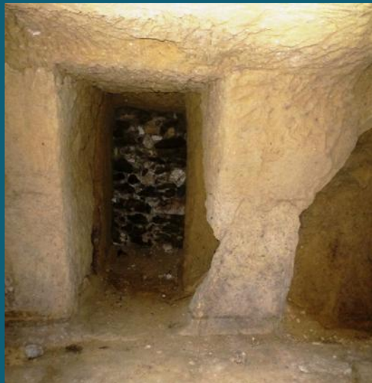
C192 Fracturation d'un pilier - PHT
