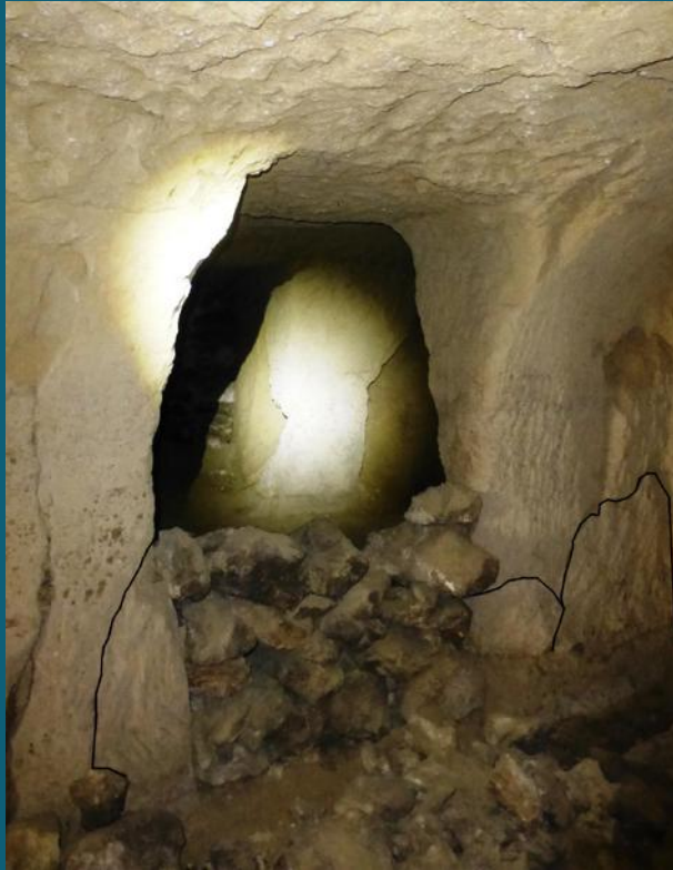
C2002 Ruptures des bases de piliers : effondrement garanti - PHT
