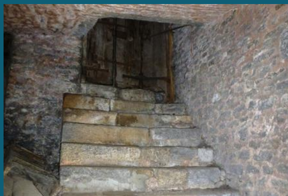
C170Bis Absence de main courante, escalier encombré... - PHT
