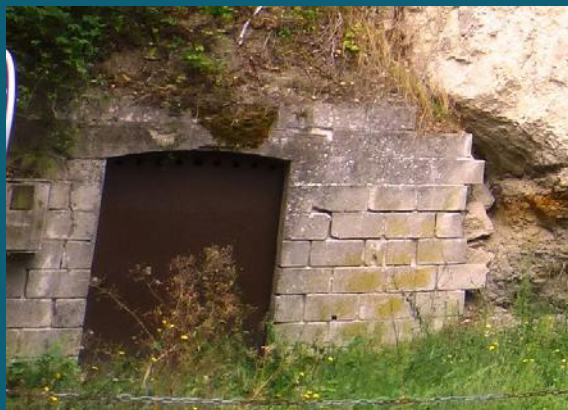
C1712 Les blocs en aggloméré de sable et ciment courants ne sont pas conçus pour les ouvrages de soutènement – PHT
