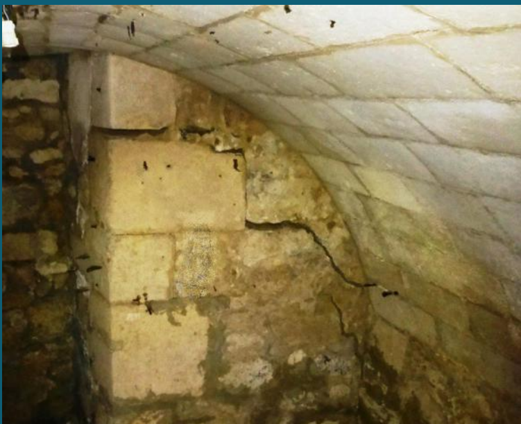
C169Bis Affaissement de piler dans une cave - PHT
