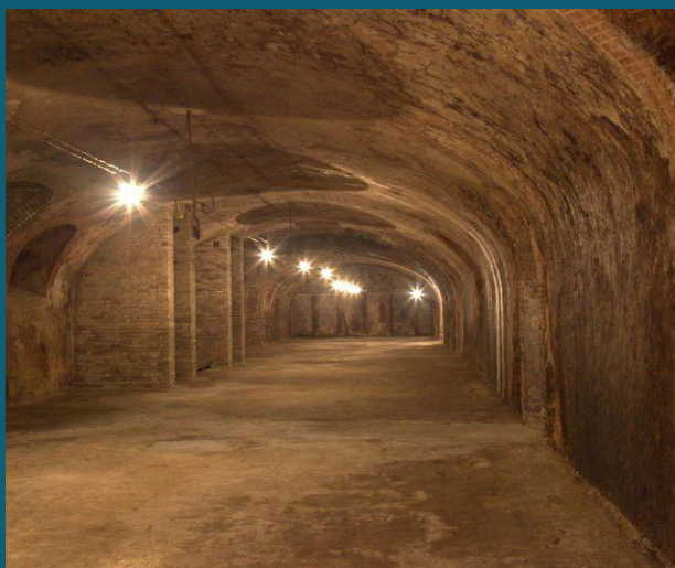
C2342 Piliers en briques dans une cave en brique et meulière et briques s'accordent à condition qu'ils soient hourdés au mortier de chaux hydraulique : Les matériaux identiques s'intègrent mieux - MG
