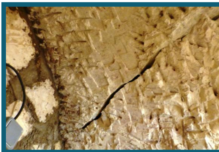
C1593 Rupture récente du toit d'une galerie : les traces d'outils Servent de témoins - PHT
