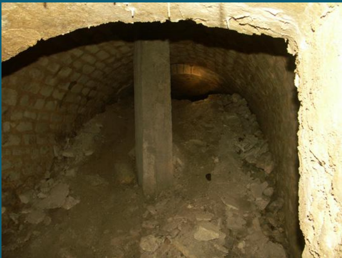
C202Bis Attention aux contraintes latérales non prévues – PHT
