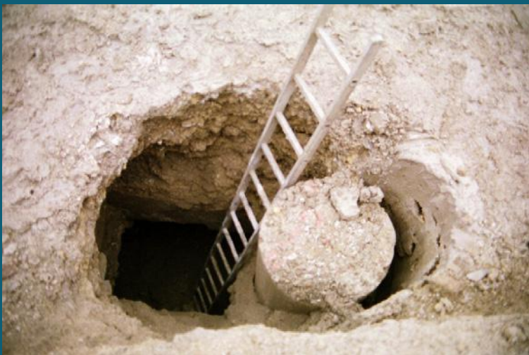
C 169 Ripage d'un pieu de fondation dans une cave oubliée - PHT
