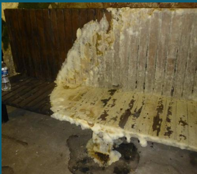
C220 C221 Ci-dessus : contamination par la mэрule, phase de fructification. (Présence à droite d'un tonneau d'eau.) - PHT
