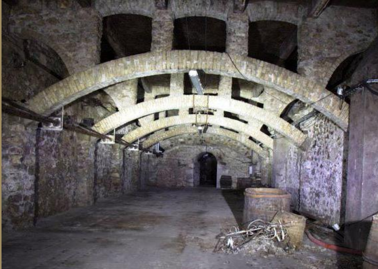
B1581 Les arcs en briques ci-dessus soutiennent d'abord la dalle du plancher en béton – PHT
