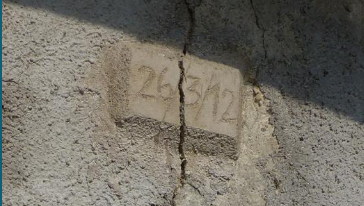
C163 Exemple de témoin réalisé en ciment prompt - PHT
